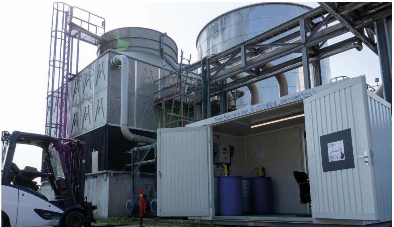
ABBILDUNG: Chlordioxidanlage Beluga mit Dosiercontainer
